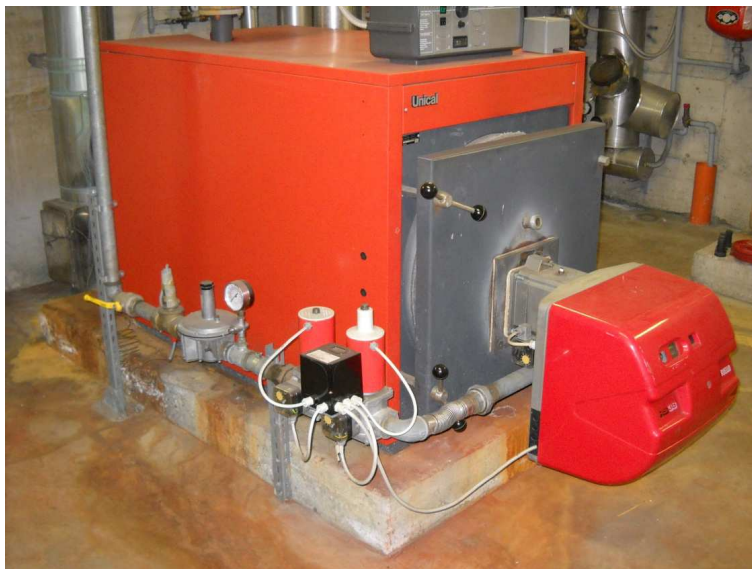
Centrale termica – caldaia esistente
