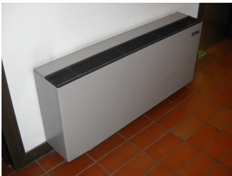
Ventilconvettori installati negli uffici
