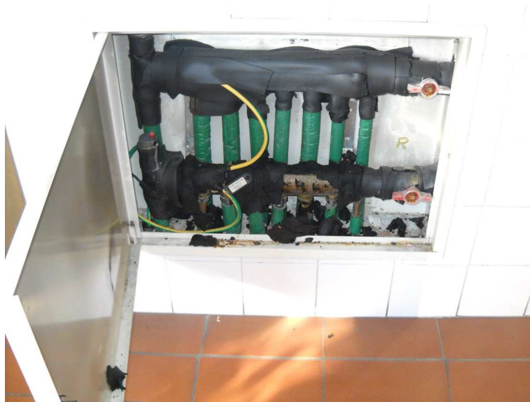
Centrale termica – caldaia esistente
